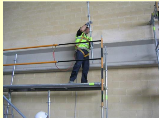
Fig.8 Barandillas provisionales. [Fuente: GESPRES]
